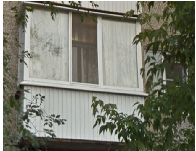
Рис.3. Обследуемый балкон 2024 г.
