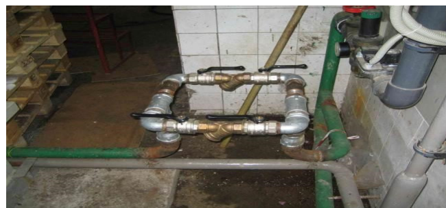
Рис.11. Фильтры на линии подачи технической воды.
